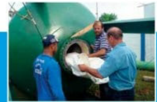
Absorbierung von Druckstoß-Wellen in einem Kraftwerk - Industrie -
