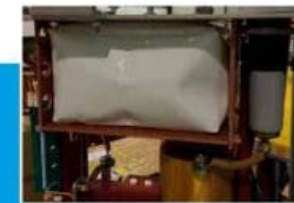
Schutz des Transformatoröls - Elektrik -
